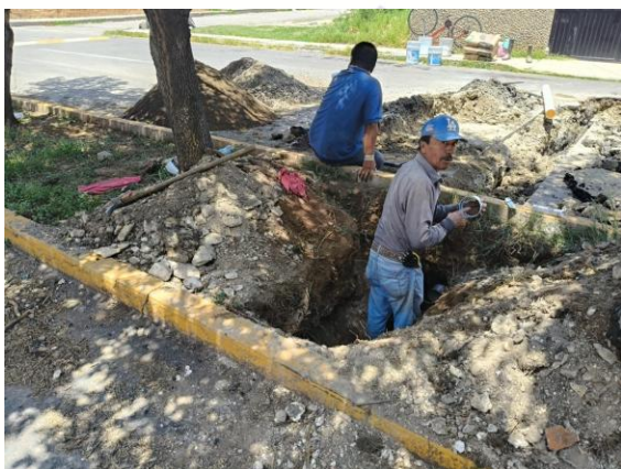
DAÑO DE RAICES
